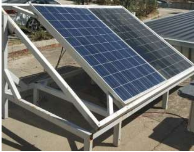
Şekil 3. PV panel kurulumu.
